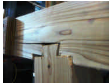
写真 4.7.6 上部材の割れ（最大変形時）
