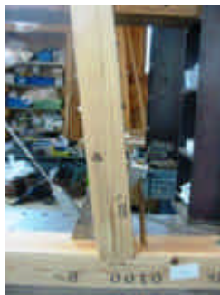
写真 4.3.3 右下接合部（最大変形時）
