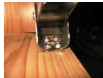
写真 4.6.6 左下接合部金物の変形 （最大変形時）
