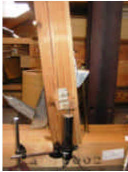
写真 4.7.3 右下接合部（最大変形時）
