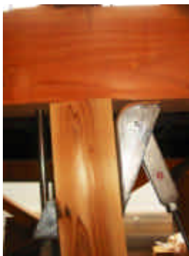
写真 4.2.5 左柱頭部（最大変形時）
