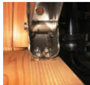
写真 4.5.6 左下接合部金物の変形（最大変形時）
