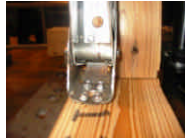
写真 4.2.4 左柱脚部金物の変形（最大変形時）
