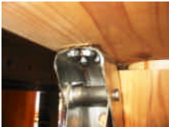
写真 4.7.5 右上接合部金物の変形 （最大変形時）
