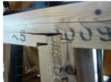
写真 4.2.6 上部材の割れ（最大変形時）
