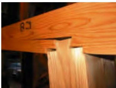
写真 4.6.5 上部材の割れ（最大変形時）
