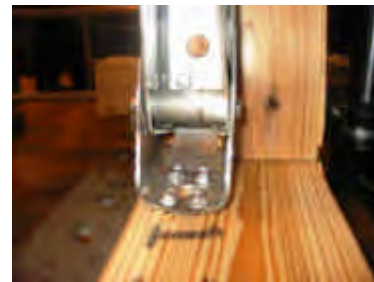
写真 4.2.4 左柱脚部金物の変形（最大変形時）
