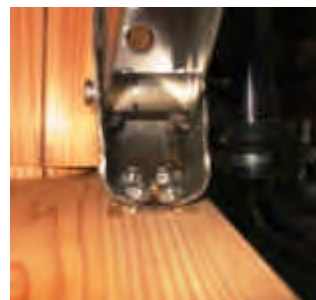
写真 4.5.6 左下接合部金物の変形（最大変形時）
