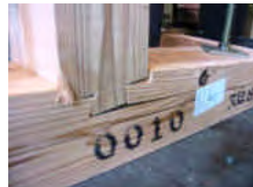
写真 4.3.4 下部材の割れ（最大変形時）
