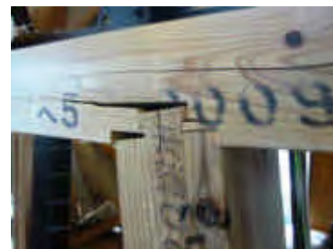
写真 4.2.6 上部材の割れ（最大変形時）
